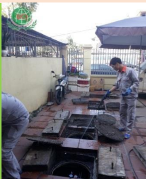
HỆ THỐNG XỬ LÝ NƯỚC THẢI
